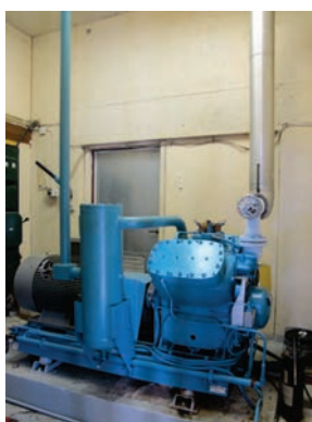
Såhär såg kompressorn och ispannan ut i det tidigare isverket
